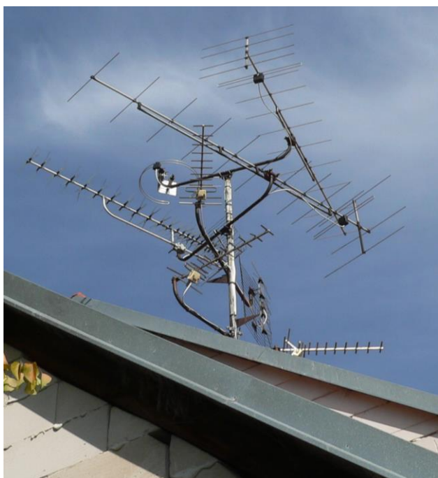
Anténní systém Vinařská 5
