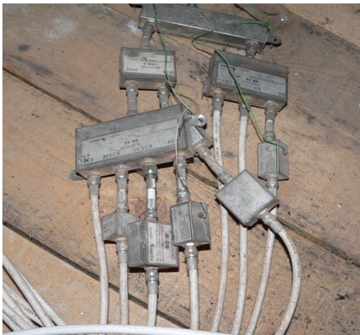
Hlavní stanice domovního rozvodu
